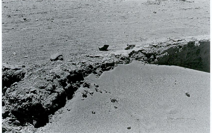
Foto 3. Grado de deterioro que muestra la casi totalidad de los muros que han sido descubiertos por el viento. Este deterioro es progresivo e irreversible. Fotografía: Mónica Bahamóndez.
