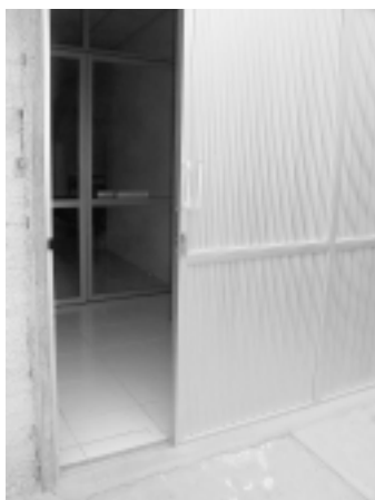
Foto 10. Puerta de aluminio acanalado, de corredera doble, con aislante, permite un control de su abertura al ingreso, evitando los cambios bruscos del medio ambiente.
