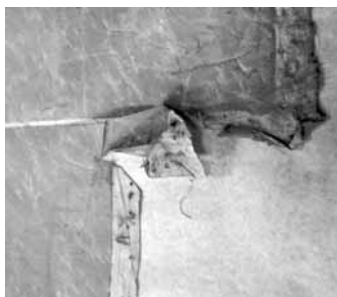
Foto 5: Detalle de deterioros. Se pueden observar los rasgados en los bordes y el corte del soporte. Octubre del 2001.
