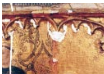
Foto 6. Durante la restauración, se rehizo el volumen faltante y posteriormente se estucó.
